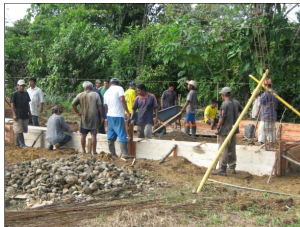
Foto 147. Proyecto compra de materiales de construcción para la Institución educativa Genaro Opúa (II)
