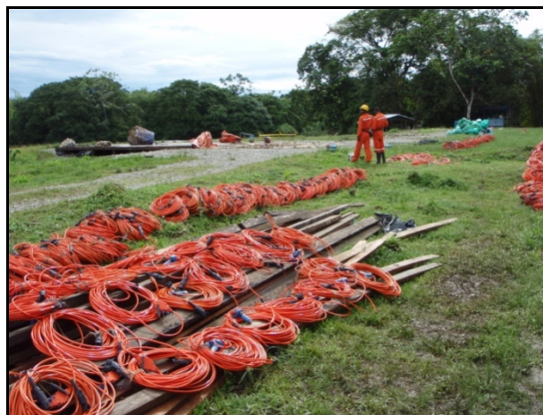
Foto 23. Mantenimiento de cables y sensores
