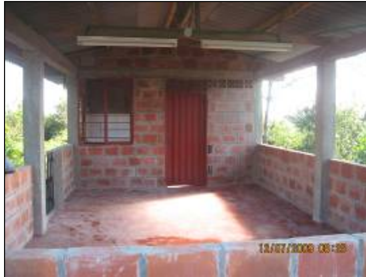
Foto 100. Proyecto construcción, adecuación y dotación de comedor escolar La Colonia sede Bachillerato
