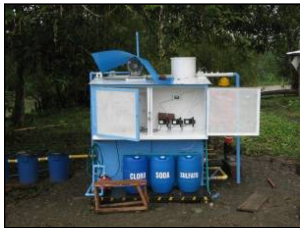
Foto 50. Planta de tratamiento de aguas residuales (PTAR). Campamento Base
