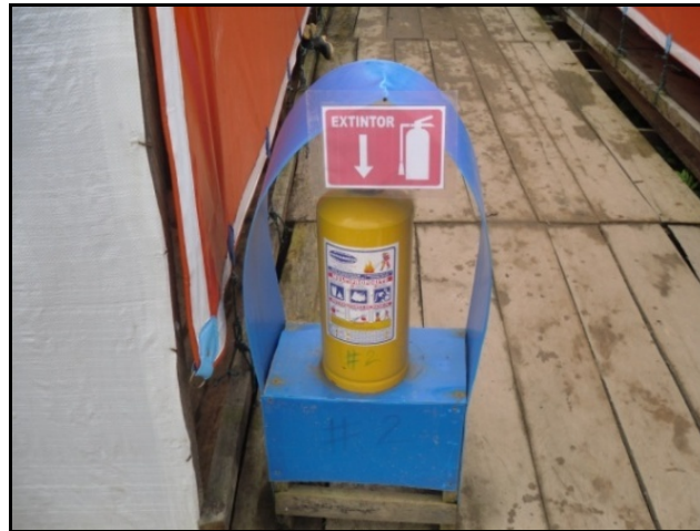
Foto 36. Ubicación de extintores ABC en la Sub-base y la Base
