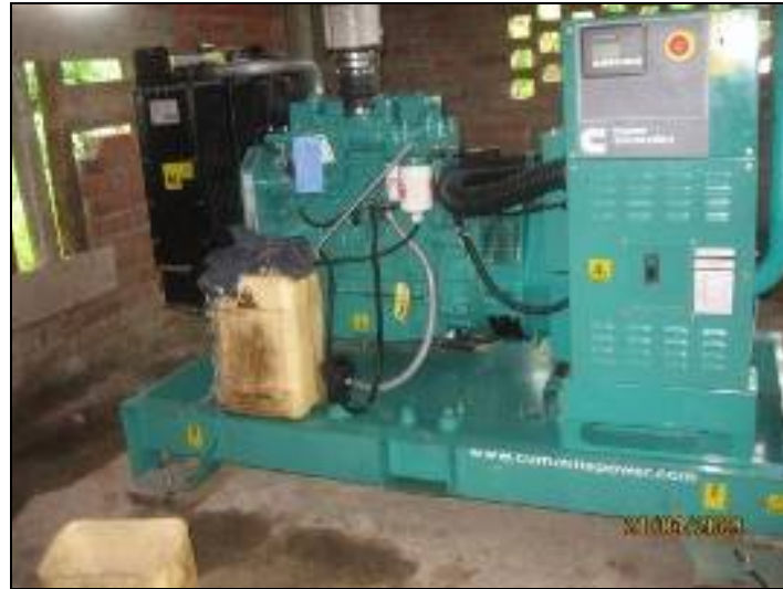
Foto 88. Planta eléctrica Vereda La Plata, del C. C. Bahía Málaga
