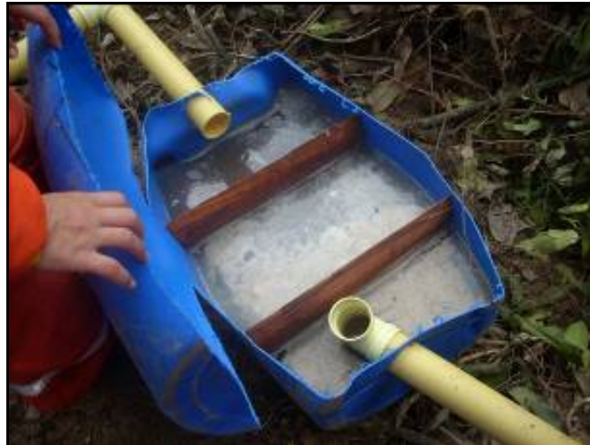
Foto 51. Sistema de Trampa-Grasa. Campamentos volantes
