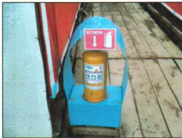
Foto 32. Ubicación de extintores ABC en la Sub-base y la Base
