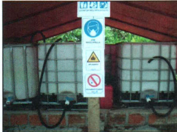
Foto 31. Señalización de riesgos en sitio de almacenamiento de combustible, Sub-base
