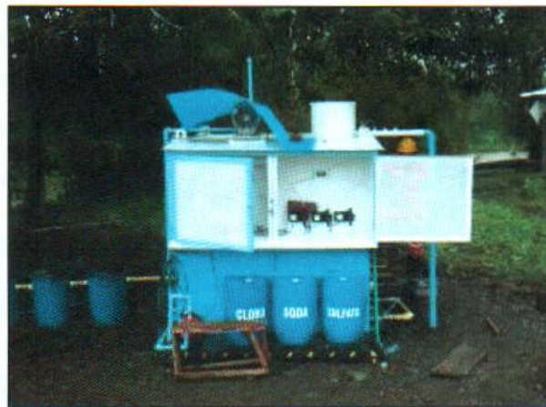
Foto 46. Planta de tratamiento de aguas residuales (PTAR). Campamento Base
