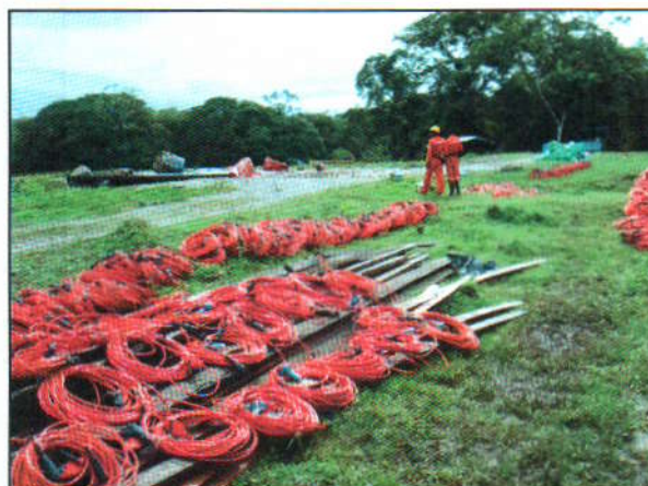
Foto 19. Mantenimiento de cables y sensores
