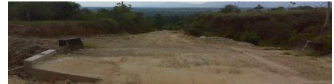
FOTO 33: Arrastre de material de la vía por efectos de la lluvia a los predios cercanos y a los drenajes y cañadas.
