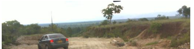
FOTO 32: Cunetas perimetrales de la vía con alto contenido de sedimentos
