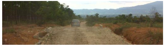
FOTO 29: Material para la vía esparcido en las zonas de alcantarilla.
