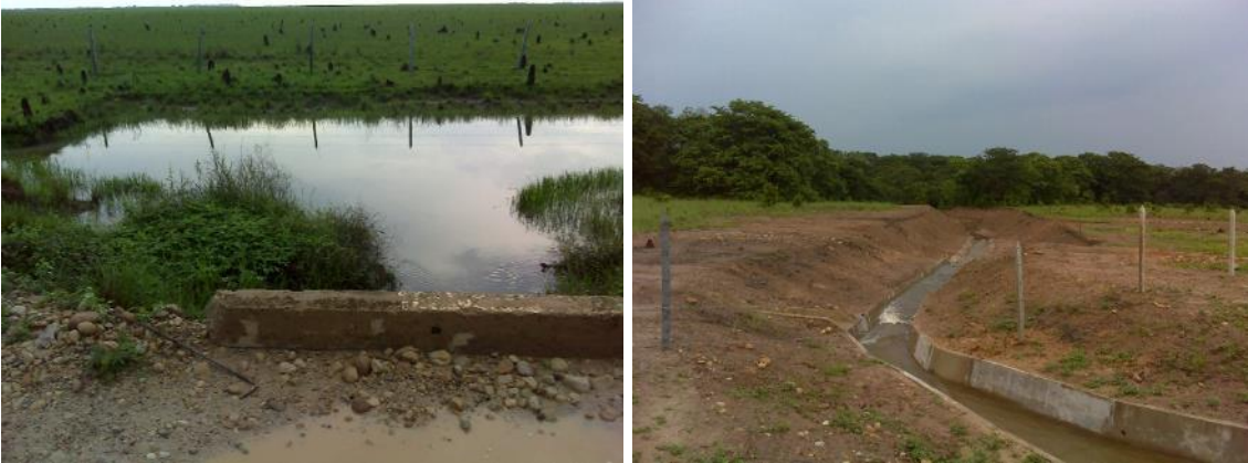
Foto 13: Obra de ingeniería (Box culvert y canaleta en cemento) realizada para drenar las aguas de una zona de préstamo hacia un caño natural.
