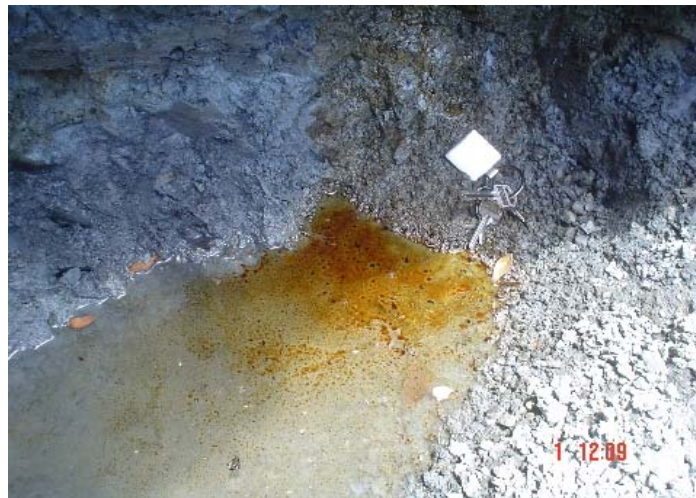
Foto 6. Detalle del rezumadero después de ocho días de represamiento.
