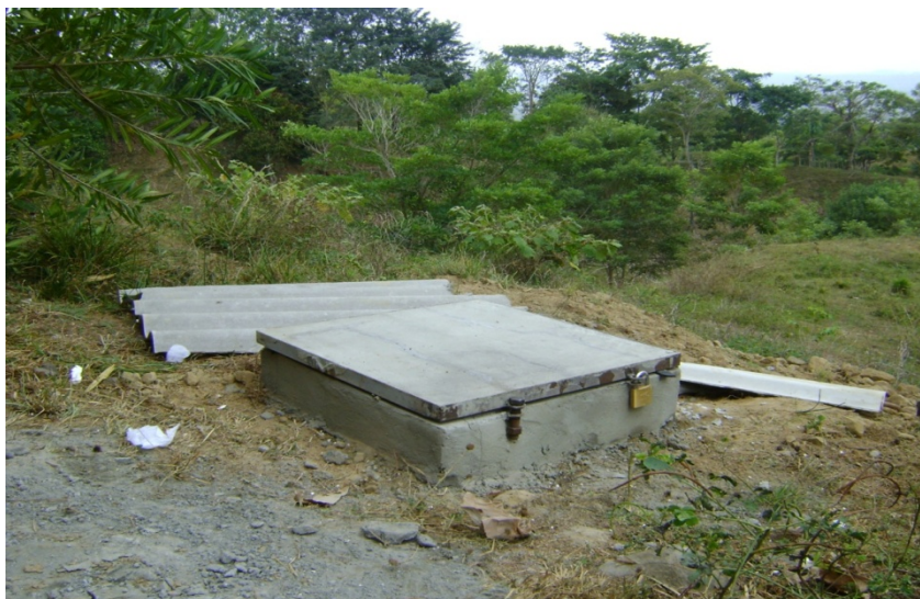
Figura 18. Vista final de la caseta para las mini-estaciones sismológicas.
