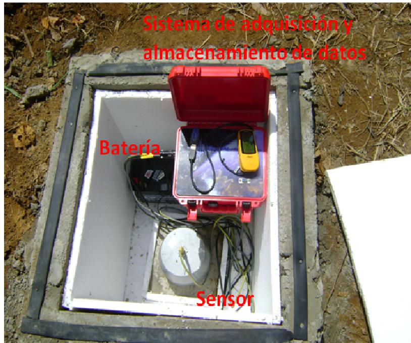
Figura 5. Ubicación de sensor, sistema digital de adquisición, GPS y baterías.
