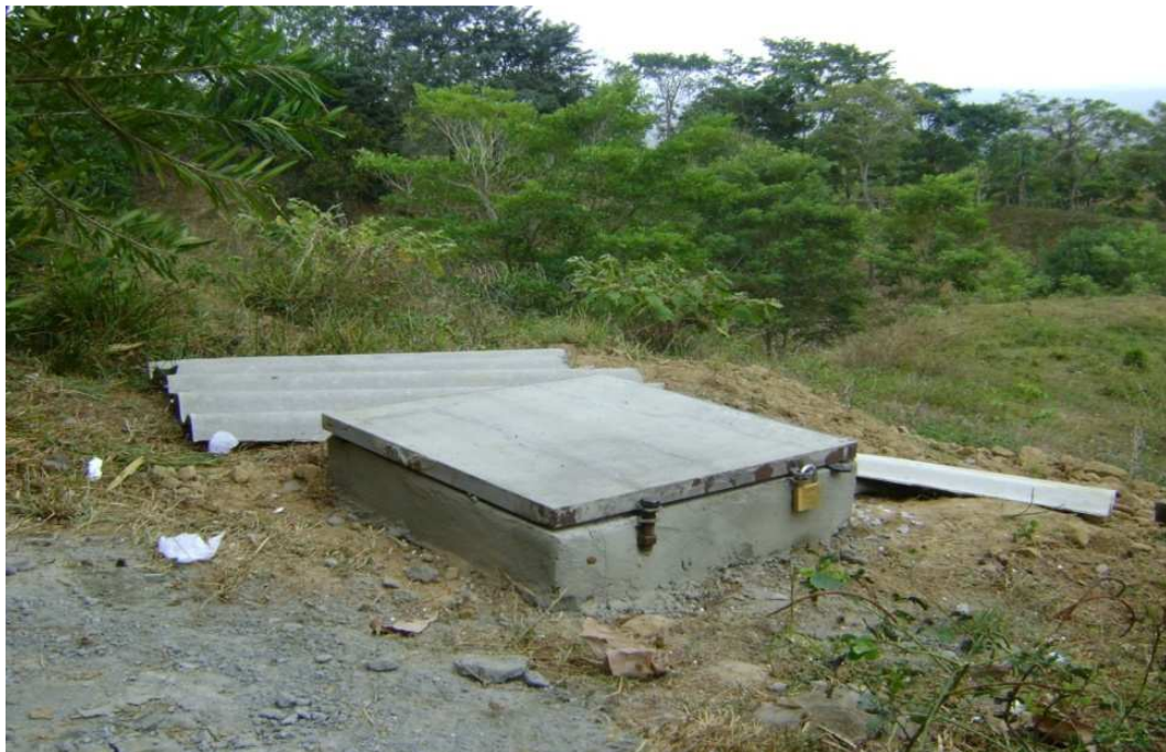
Figura 6. Mini caseta para estación sismológica, con tapa delgada en concreto que protege la estación y permite la recepción de GPS.
