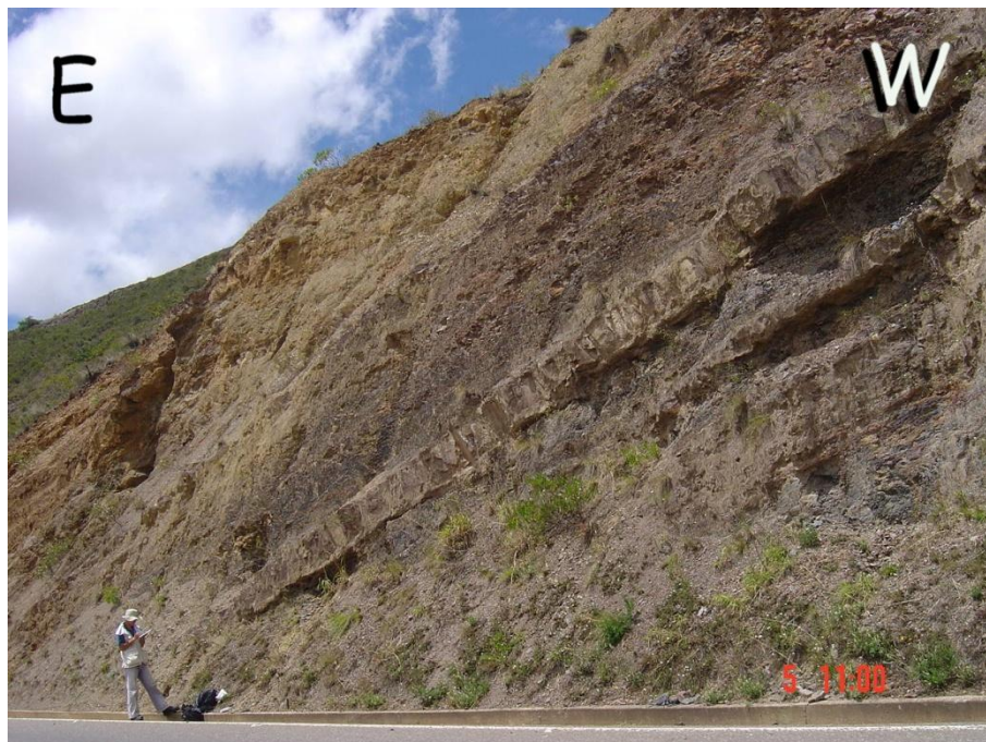
Figura 42. Margen izquierda de la vía Alto del Arrayán – Peaje Sáchica, sector Alto del Arrayán. Nótese el estado de las rocas duras (arenitas calcáreas) respecto a las blandas (lodolitas grises) dentro de los estratos para la Formación san Gil en el sector.
